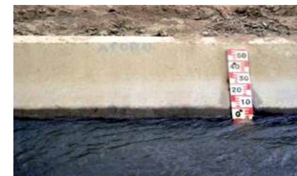
Figura 27. Estación de aforo.
