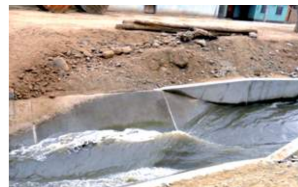
Figura 13: Rastro del desborde al límite de la pared lateral a la salida de la transición e inicio del canal
