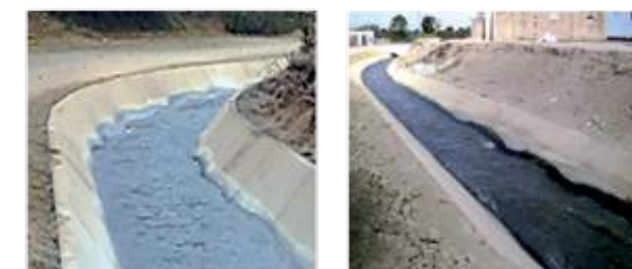
Figura 14-15. Tramos de canal con flujo turbulento desordenado y formación de oleajes.
