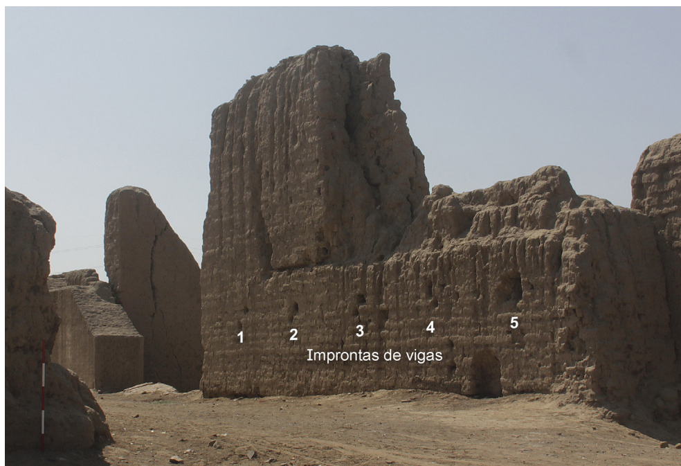
Fig. 7: Vista suroeste de la fachada interior del muro norte, o pared derecha, del santuario. Nótase la distribución de improntas de las estructuras de madera que se encontraban empotradas.
